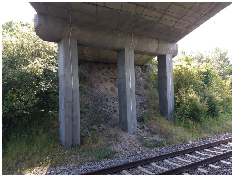
Vnitřní podpěra 3 s ocelovou sítí
