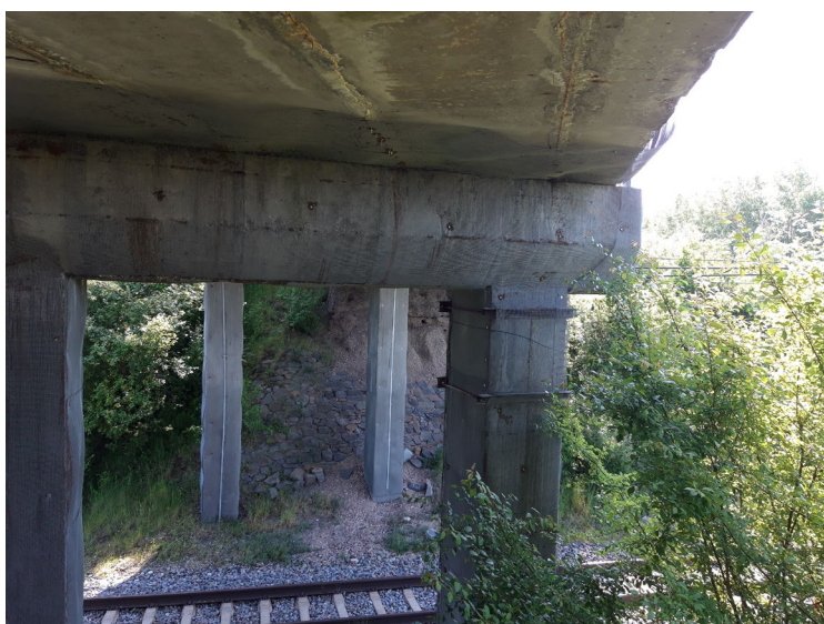
Vnitřní podpěra 2 s ocelovou sítí
