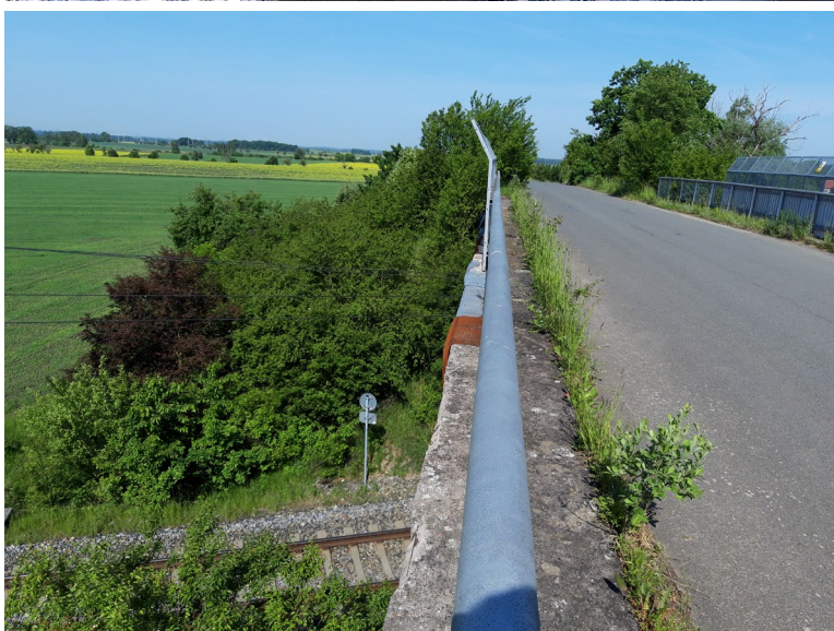
Pravý okraj nosné konstrukce v poli 3 Degradace betonu Rozpadající se beton římsy Koroze sítí
