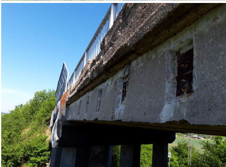
Pravý okraj nosné konstrukce v poli 3 Degradace betonu Rozpadající se beton římsy Obnažené kotvy příčného předpětí
