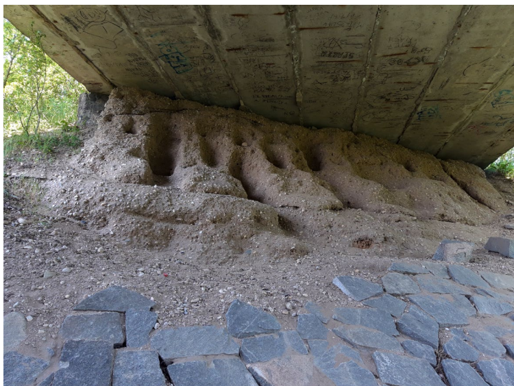
Eroze svahu pod mostem u opěry 1
